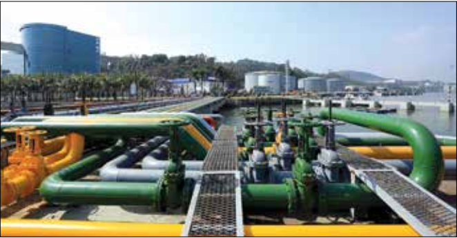
Hệ thống tuyến đường ống tiếp nhận, bơm chuyển xăng dầu của Công ty Xăng dầu B12.
